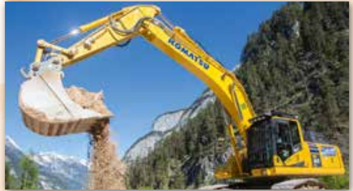
Der Hybridbagger HB365-LC3 wird zum allergrößten Teil für die Rohstoffgewinnung im SSK-Kieswerk in Saalfelden eingesetzt.
